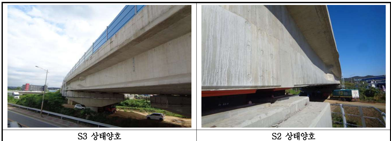
【사진 32.3.5】 거더 손상현황
