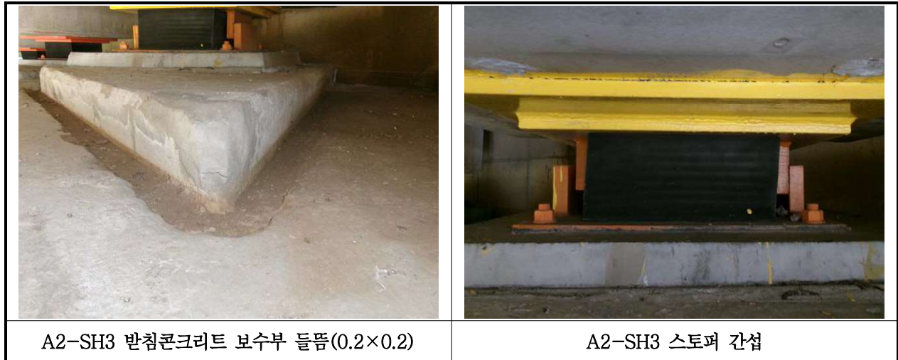
【사진 32.3.13】 교량받침 손상현황
