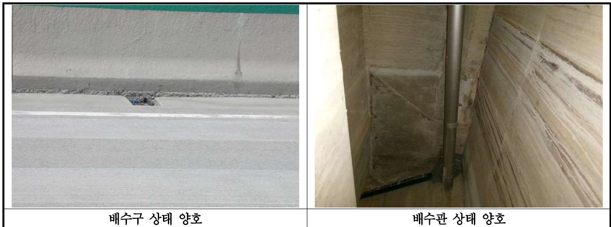
【사진 31.3.22】 배수시설 손상현황
