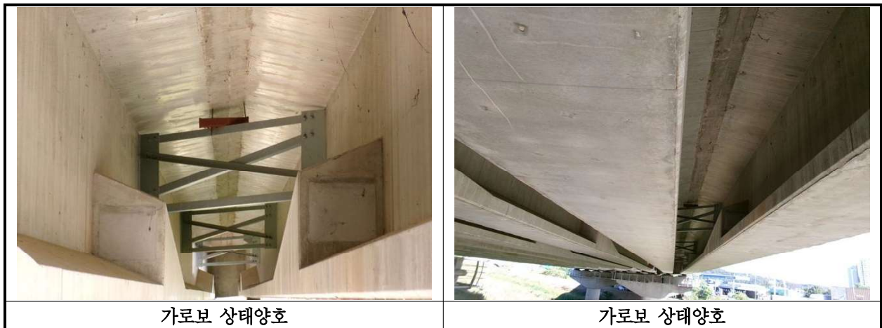
【사진 32.3.7】 가로보 손상현황
