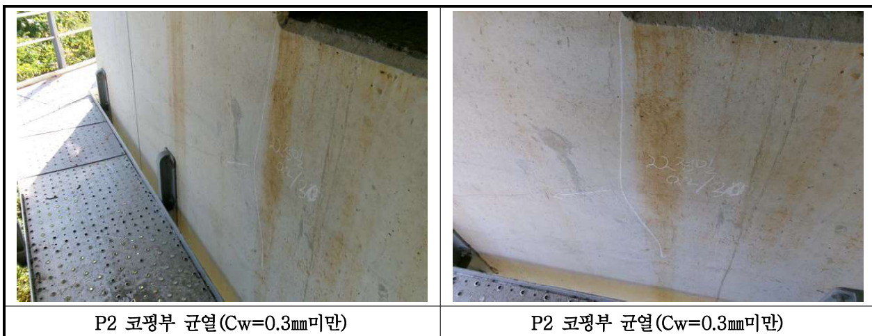
【사진 32.3.11】 교각 손상현황
